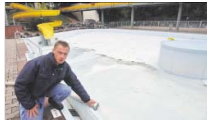
Mitarbeiter Michael Hegener am Aktionsbecken der Schönen Flöte: Das Becken weist erhebliche Mängel auf. (Foto: Brock)
